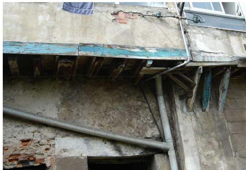
Deterioro provocado por el mal estado de una bajante
