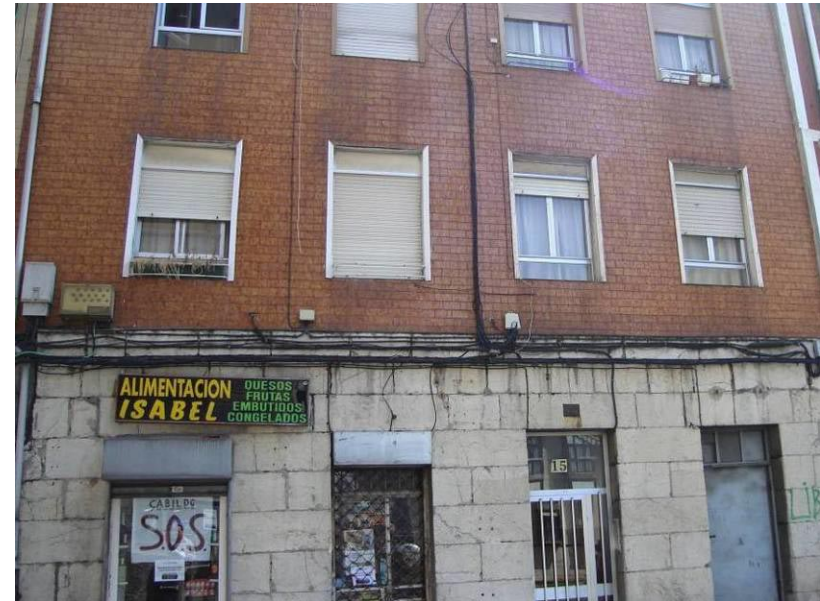
Materiales de revestimiento y cerramiento ajenos a la tipología original
